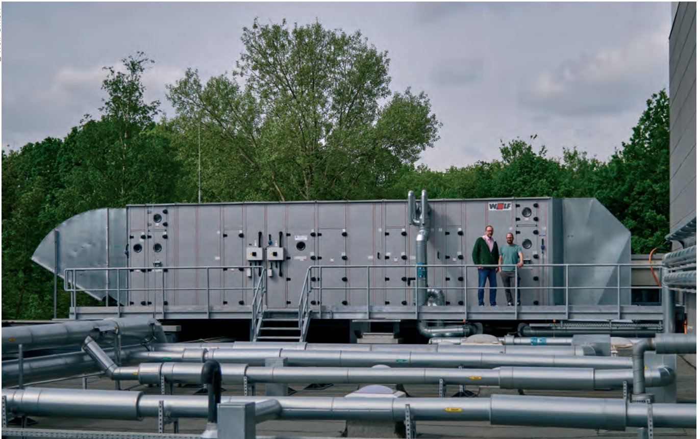
! Zwei WOLF Lüftungsgeräte KG Top versorgen die Halle seit 2021 bedarfsgerecht, hygienisch und komfortabel mit bis zu 200.000 m 3 Frischluft pro Stunde.
