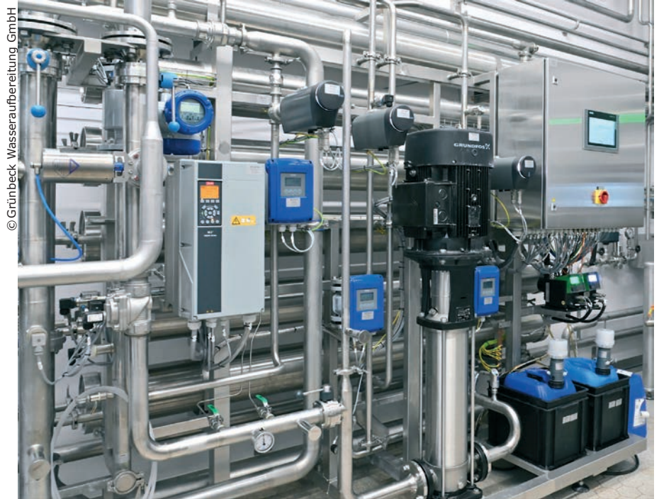
Die Grünbeck-Wasseraufbereitungsanlage in der Brauerei Frastanz. Ihr Herzstück ist die Umkehrosmoseanlage GENO-OSMO-RKF 12.500, die pro Stunde bis zu 12,5 m 3 vollentsalztes Wasser liefert, das in der nachgeschalteten Verschneideeinrichtung mit Rohwasser vermischt wird, um die optimale Brauwasserhärte zu erreichen.
