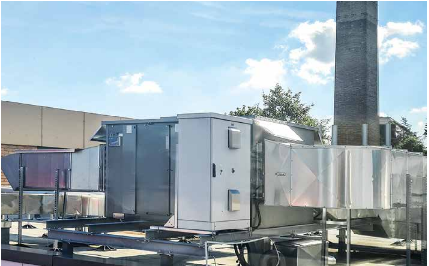
Die zentralen Lüftungsgeräte der Serie DUPLEX Multi Eco-N sind auf dem Dach montiert. Sie versorgen die innenliegenden Sanitär-, Lager- und Technikräume sowie die Sporthalle.
