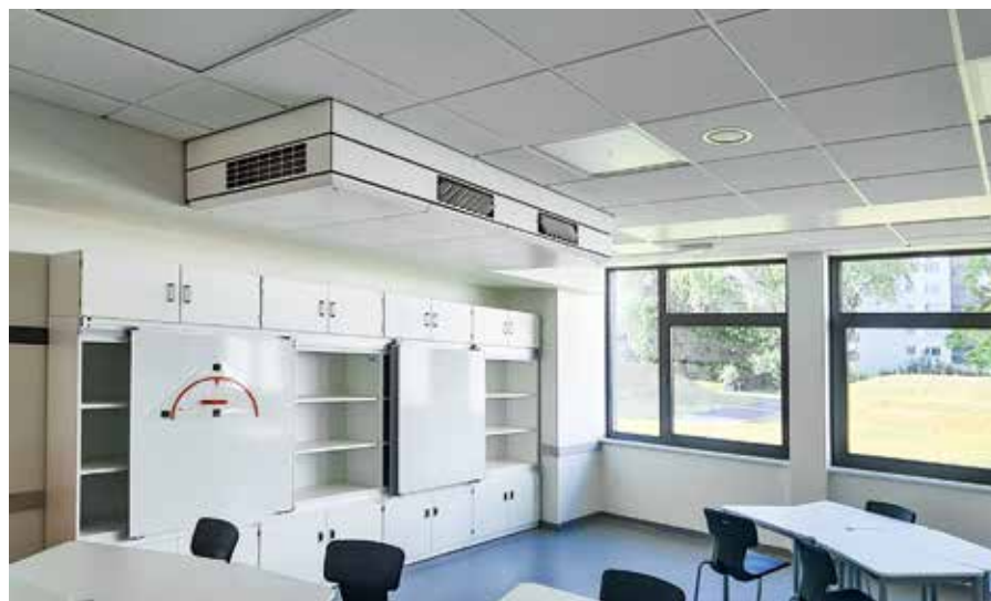
! Durch den Wegfall aufwändiger Luftkanäle war der Installationsaufwand in den Klassenräumen gering.
