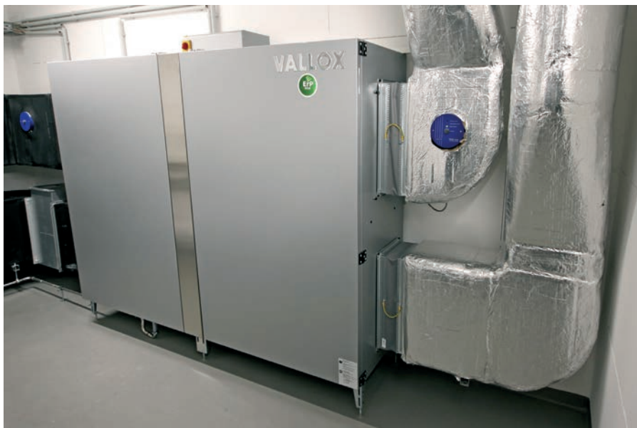
I Ein zentrales Großgerät aus der COMMERCIAL LINE SERIE für die Lüftung der „Tanzenden Siedlung“.
