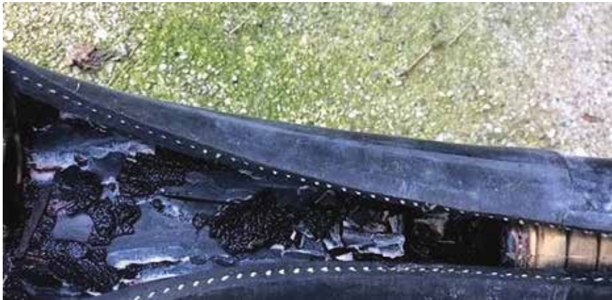
I Bild 3: Diffusionsoffener Gummischlauch mit deutlichen Magnetitablagerungen auf der Innenseite. Platzen diese ab, kommt es zu Störungen von BHKWs oder Wärmepumpen. Edelstahlwellrohre schaffen hier Abhilfe.
