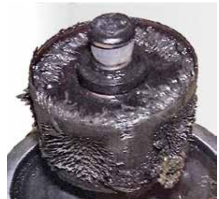
I Bild 2: Moderne Naszläuferpumpen reagieren sensibel auf Magnetit im Anlagenwasser.
