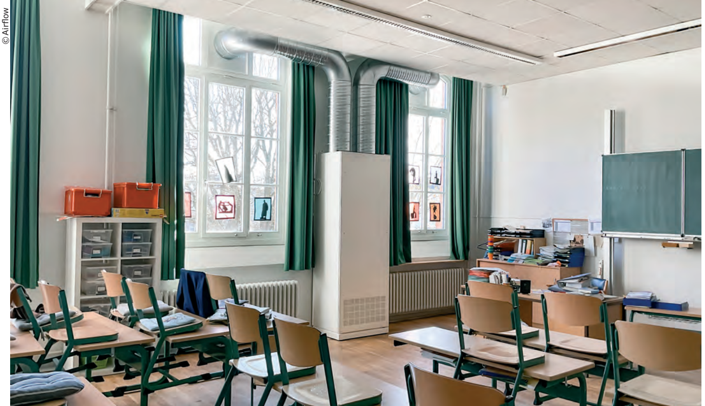
Um den Schülern und Lehrern in der Aachener Grundschule Düppelstraße eine gesunde Lernatmosphäre zu bieten, wurden in allen 25 Klassenzimmern moderne Lüftungsgeräte des Herstellers Airflow installiert.
