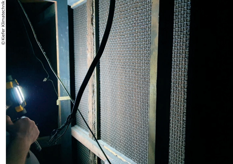
Ein Blick hinter die alten Kulissen: Die Holzvertäfelung ist mit einer blickdichten Stoffrückseite versehen. Dahinter werden in Zukunft die neuen Kiefer INDUQUELL Luftauslässe installiert.
