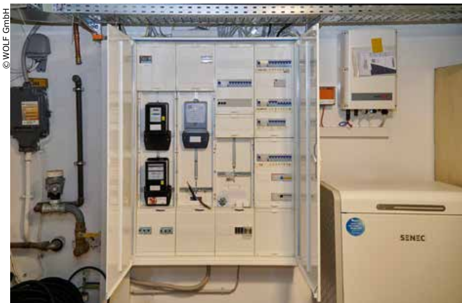
Überschüssige Energie der PV-Anlage wird in einem SENEK Batteriespeicher mit 25,2 kWh Ladekapazität im Heizraum gespeichert.
