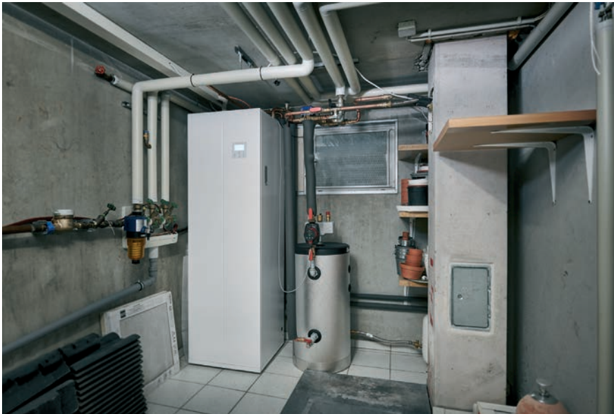
! Aufgeräumt präsentiert sich der Heiztechnikraum, nachdem die alte Ölanlage durch die Wärmepumpe ersetzt wurde.
