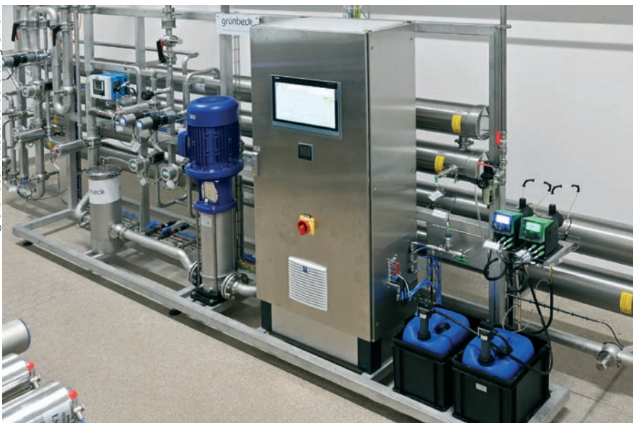
! Zwei baugleiche Umkehrosmoseanlagen hat Auerbräu in dem von Brauereigründer Johann Auer errichteten Gewölbekeller installiert.
