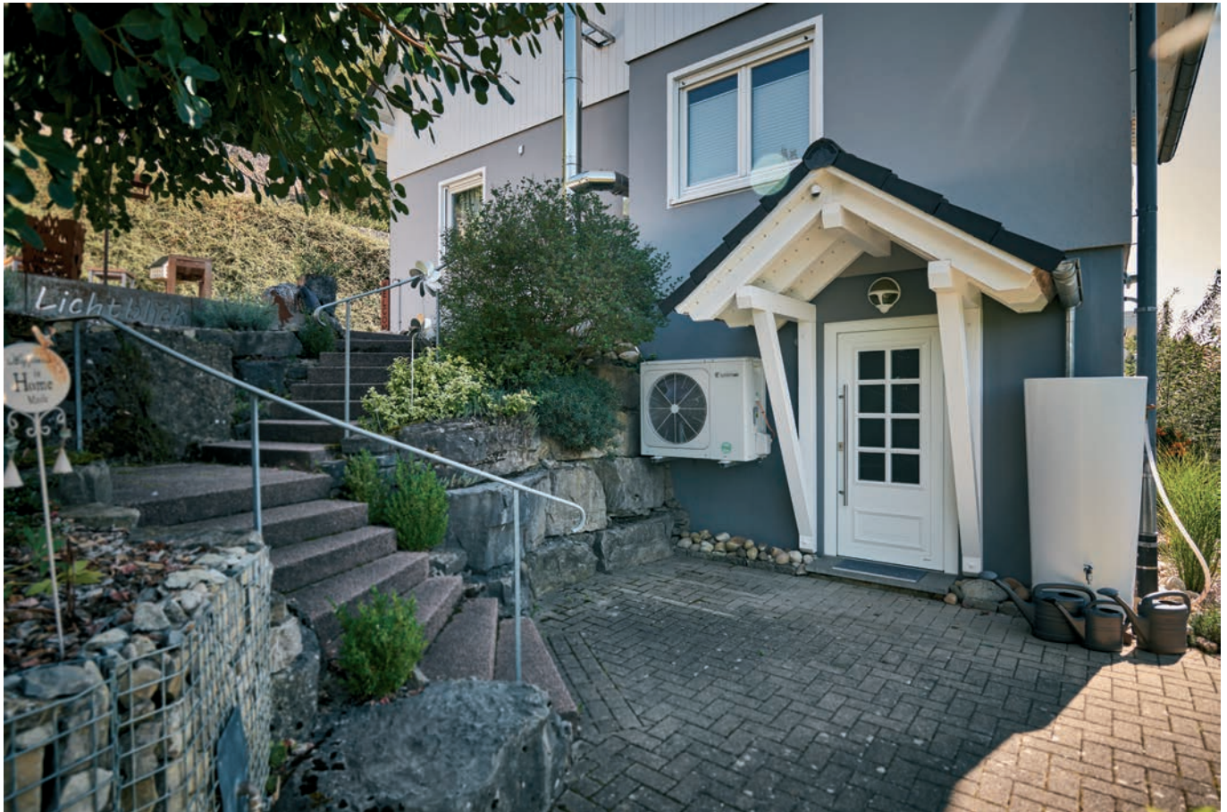
! Raum ist in der kleinsten Ecke: Die kompakte Außeneinheit der „SYSHP MINI“-Wärmepumpe fand ganz dezent neben der Nebeneingangstür ihren Platz. Ideal in doppelter Hinsicht, denn direkt dahinter liegt der Heizraum.
