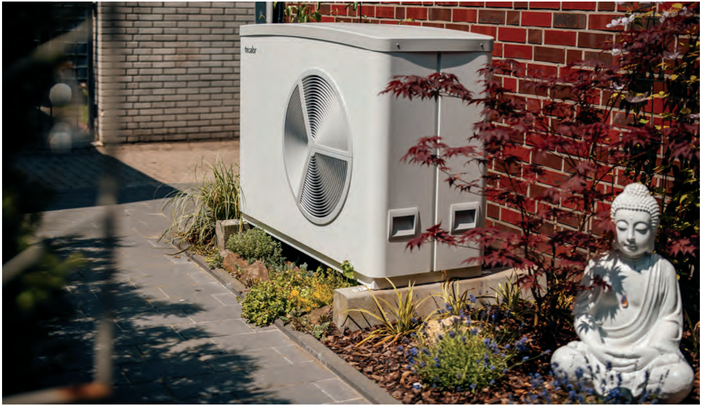
Die außen aufgestellte Luft-Wasser-Wärmepumpe TTL 25 A fand ihren Platz im Hof hinter dem Wohngebäude.
