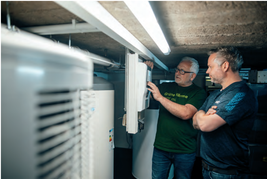
Die Warmwasserbereitung erfolgt über zwei Warmwasserwärmepumpen – eine für jede Wohneinheit.
